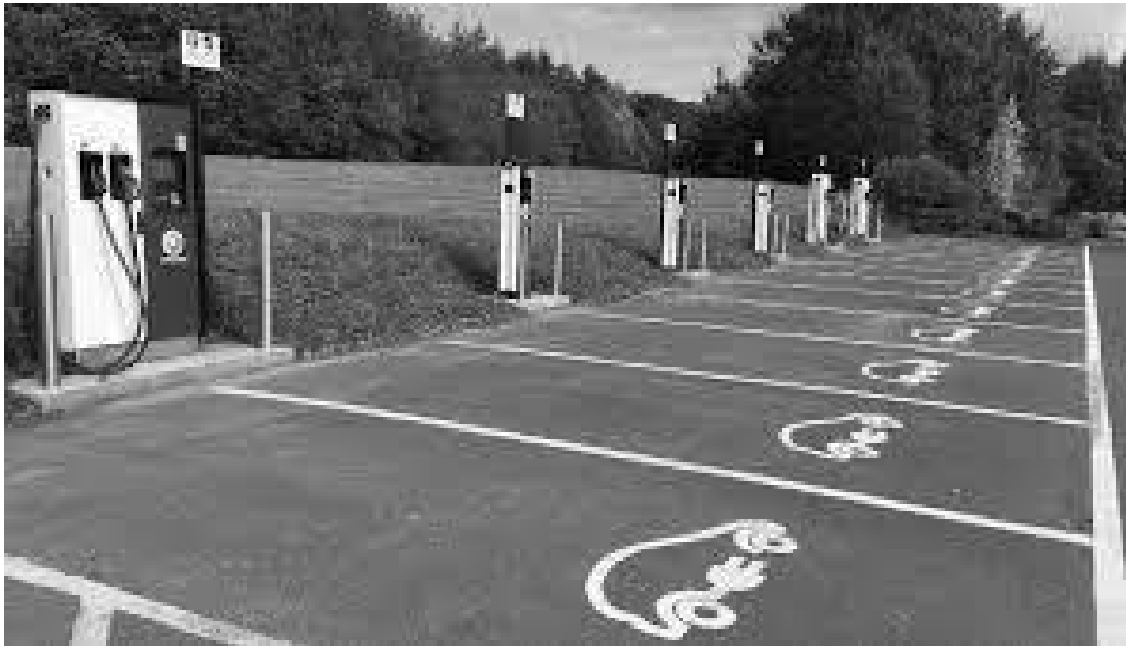
Εικόνα 6.2: Παράδειγμα χώρου στάθμευσης με εξοπλισμό φόρτισης ηλεκτρικών οχημάτων
